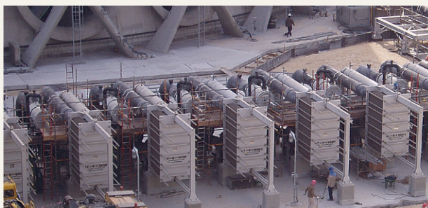
石油プラントのセントラルクーリングシステム
