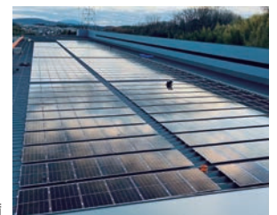
生駒事業所の太陽光発電設備
