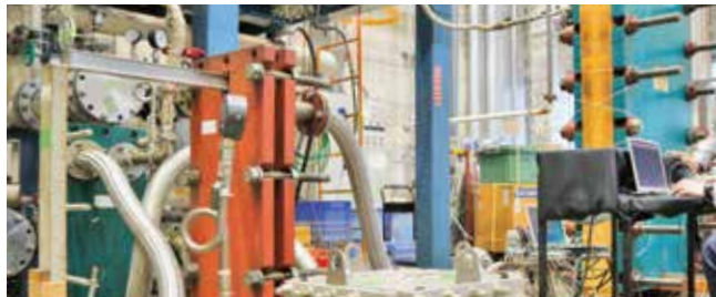
熱交換器開発試験室 国産初のプレート式熱交換器を開発したフロンティア精神を受け継ぎ、これまで培ってきた技術を進化させながら、世界に通用するプレート式熱交換器の研究開発を続けています。
