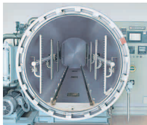
処理槽内のノズル配管
