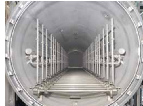
スプレー式の滅菌槽内部
