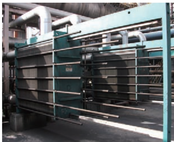
高炉冷却、連铸設備冷却、COG、各種メッキ液冷却
