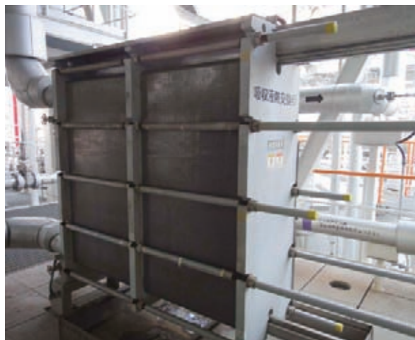
CO 2 回収、脱硫プラントの溶液熱交
