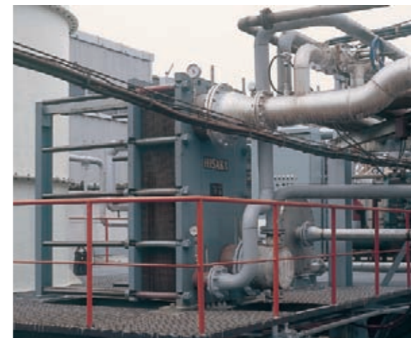
溶剤回収、排ガス冷却
